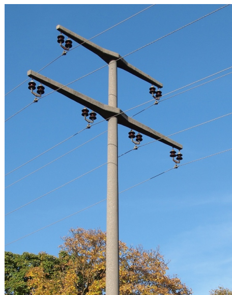
Abbildung 24: 20-kV-Mittelspannungsleitung: power=minor_line , Mast: power=pole . An den Way kann noch: voltage=20000 ; frequency=50 ; cables=6 ; circuits=2 ; wires=single .
