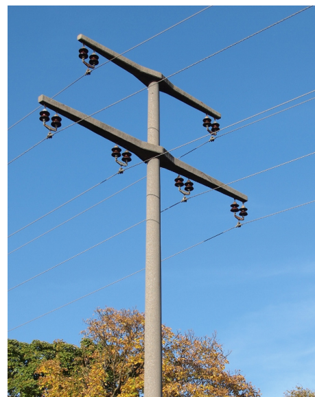
Abbildung 26: 20-kV-Mittelspannungsleitung: power=minor_line , Mast: power=pole . An den Way kann außerdem noch: voltage=20000 ; frequency=50 ; cables=6 ; circuits=2 ; wires=single . Diese Werte aber bitte nur taggen, wenn du dir sicher bist, dass sie stimmen!
